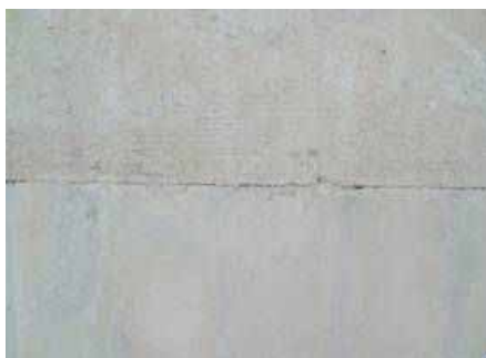
施工前クラック状況
